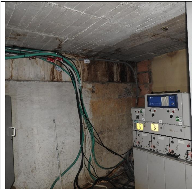
Seccionador media tensión
