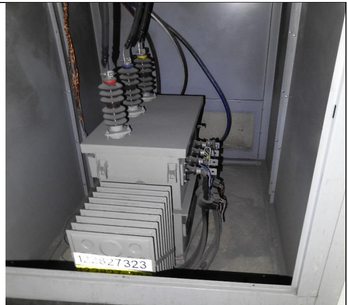
Transformador en aceite 112.5
